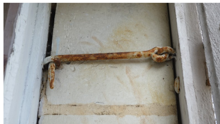
Fig. 23 - Ardon (Loiret), château de Boisgibault A gauche, la croisée. A droite, les persiennes ferrées sur un bâti dormant, l'ensemble étant maintenu par des crochets à la croisée.
