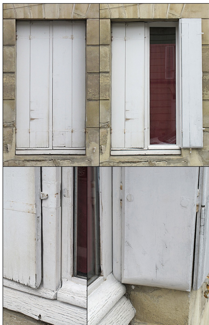
Fig. E.3. Caen, immeuble du XIX e siècle Croisée du rez-de-chaussée Ici le cochonnet est limité et les feuilles sont repliées sur le tableau et la façade, au contraire de Versainville (cochonnet de 65 mm pour replier les feuilles en tableau)
