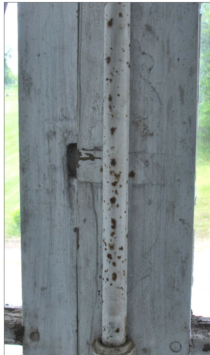
Fig. E.4. Château de Versainville Croisée du pavillon (targette supérieure) A droite de l'axe de fermeture, on remarque le spectre de la platine à panaches (sous la peinture) et l'emplacement du pêne rebouché par une cale en bois. A gauche, on devine l'emplacement de la gâche éliminée.
